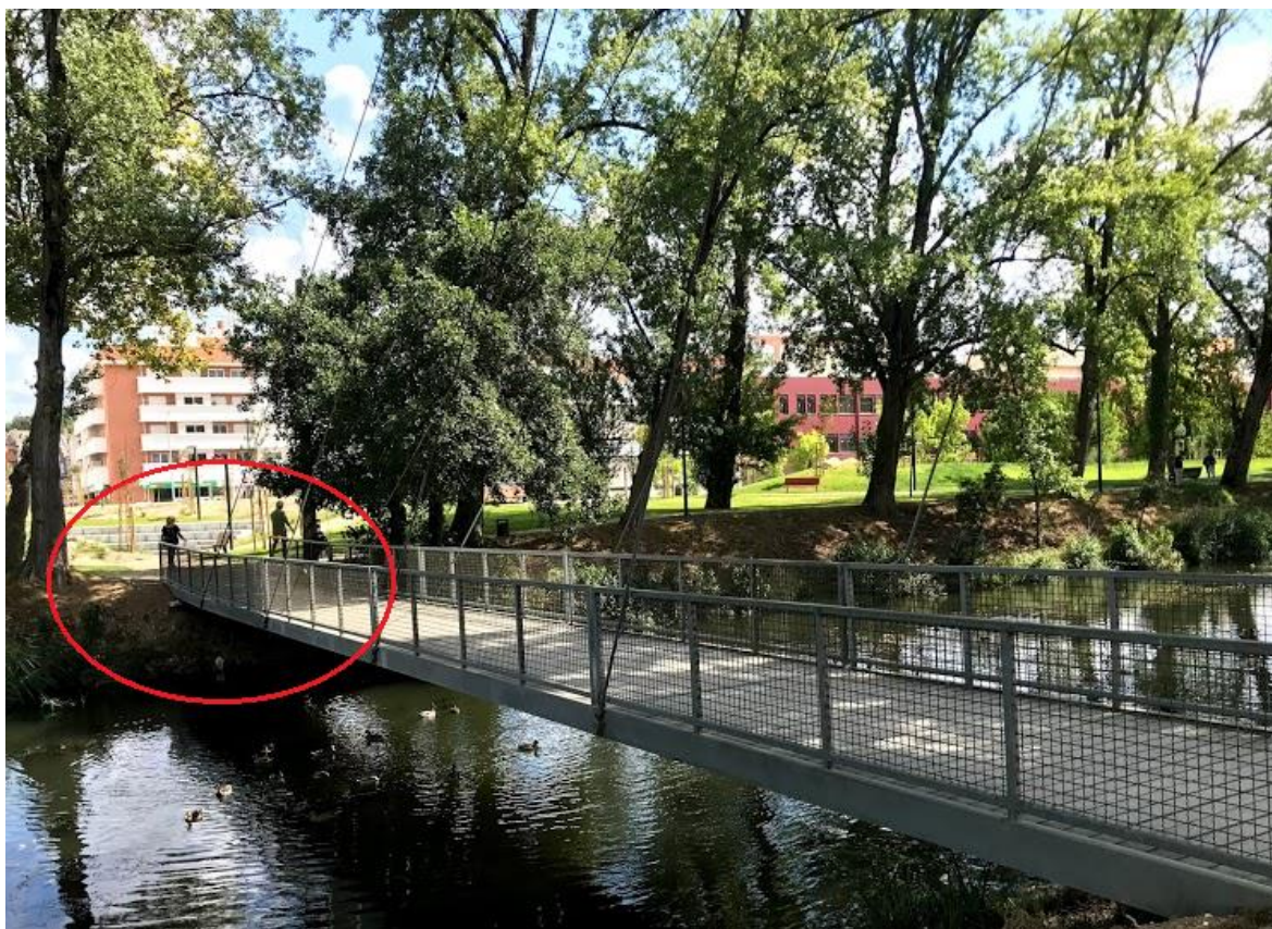
Figura 46 - Deformação do tabuleiro nos últimos tramos.
