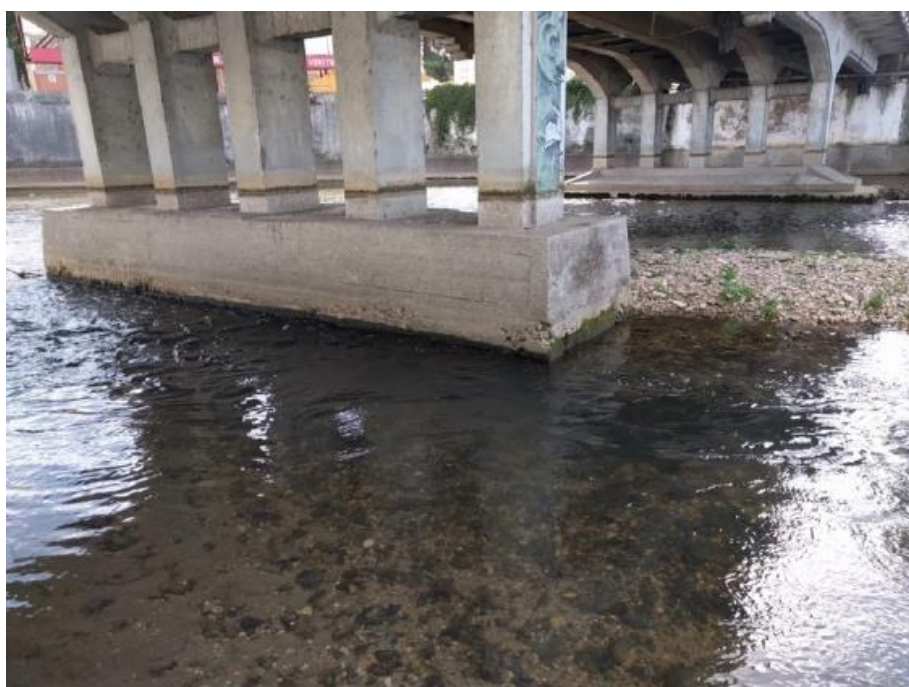
Figura 40 - Erosão mais relevante em um dos lados da sapata.
