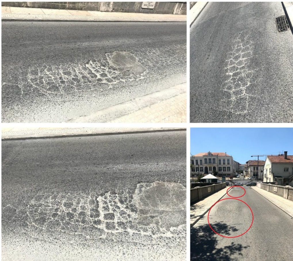
Figura 61 - Patologias no revestimento betuminoso.
