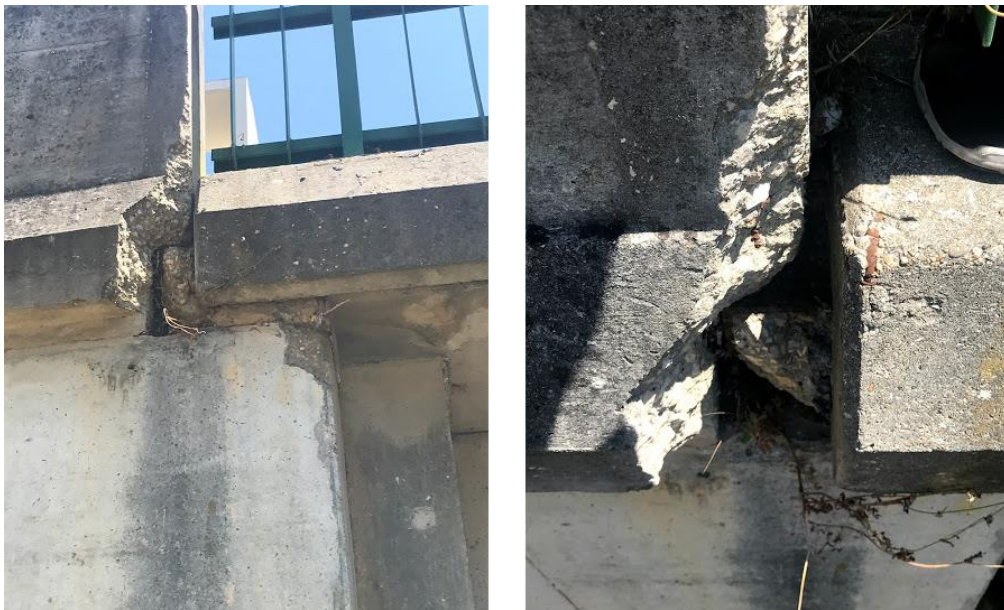
Figura 24 - Exposição de armadura e vegetação na junta.
