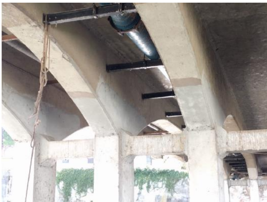
Figura 38 - Manchas e sinais de restauro na mesoestrutura.
