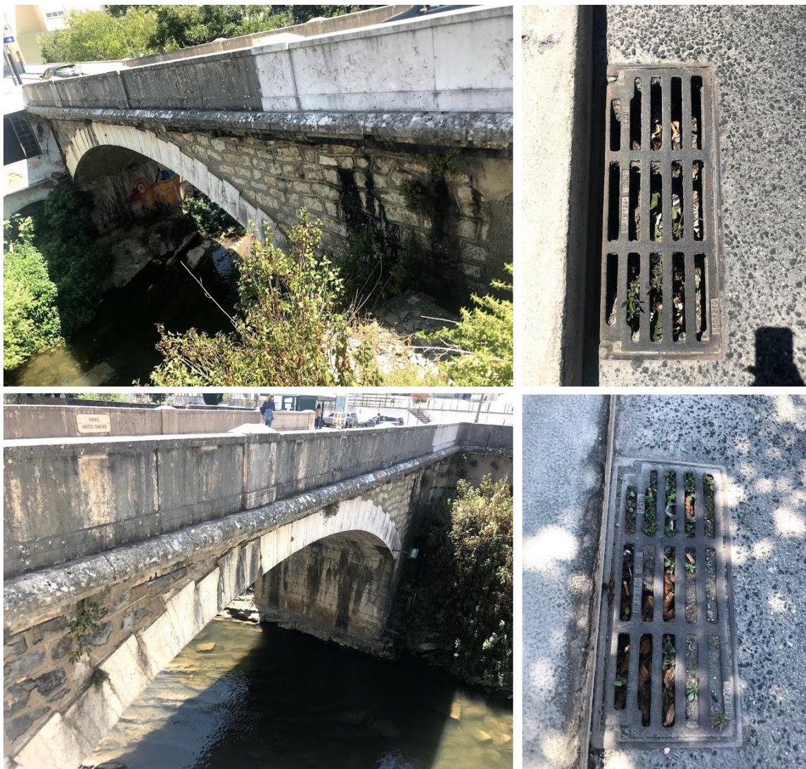
Figura 63 - Patologias encontradas no tabuleiro e sistema de drenagem.
