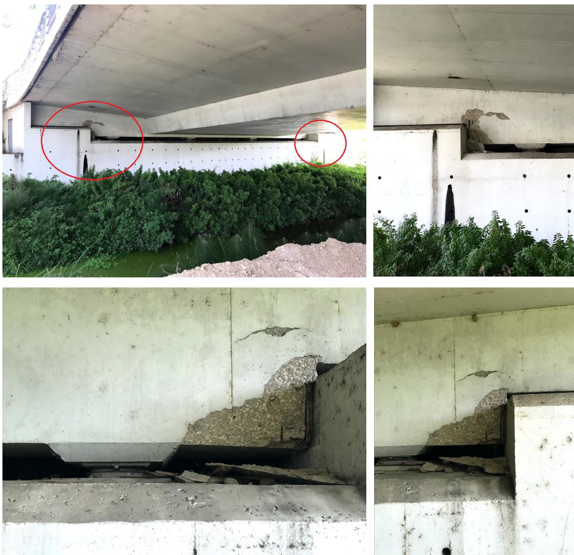
Figura 56 - Deficiência de funcionamento do encontro norte.
