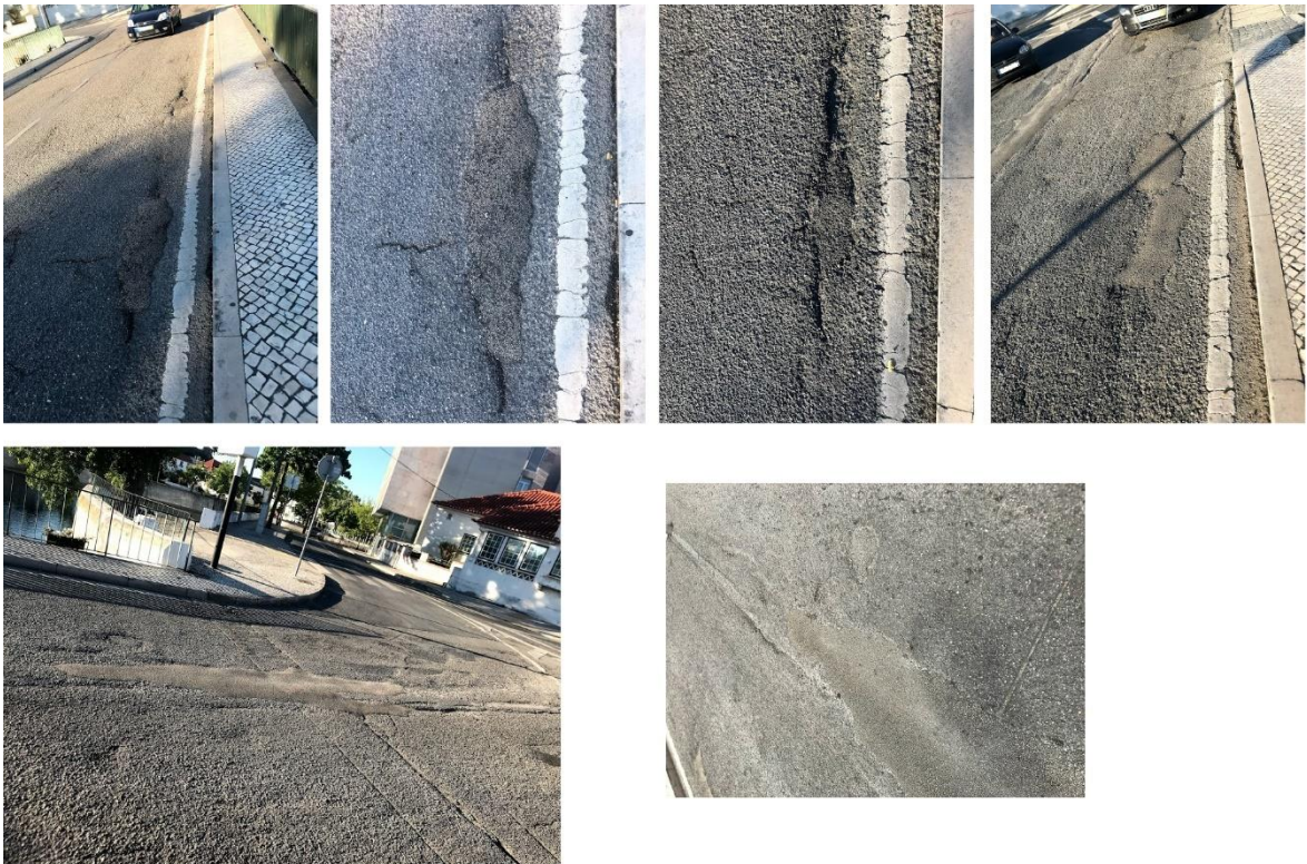
Figura 33 - Desagregações, peladas e tapagem de covas.
