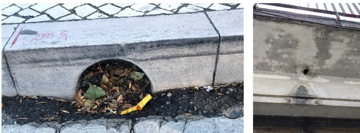
Figura 37 - Deficiência no sistema de drenagem.
