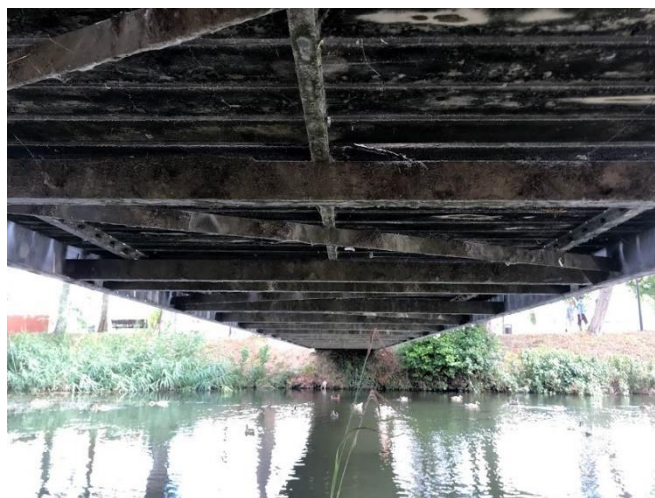
Figura 44 - Pavimento na parte inferior com manchas e estrutura com deficiência de limpeza.
