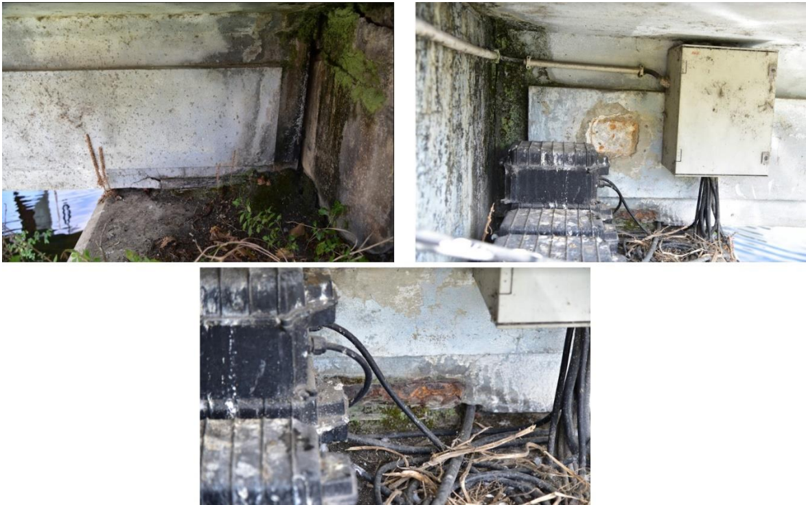
Figura 39 - Deficiência nos aparelhos de apoios e encontros.
