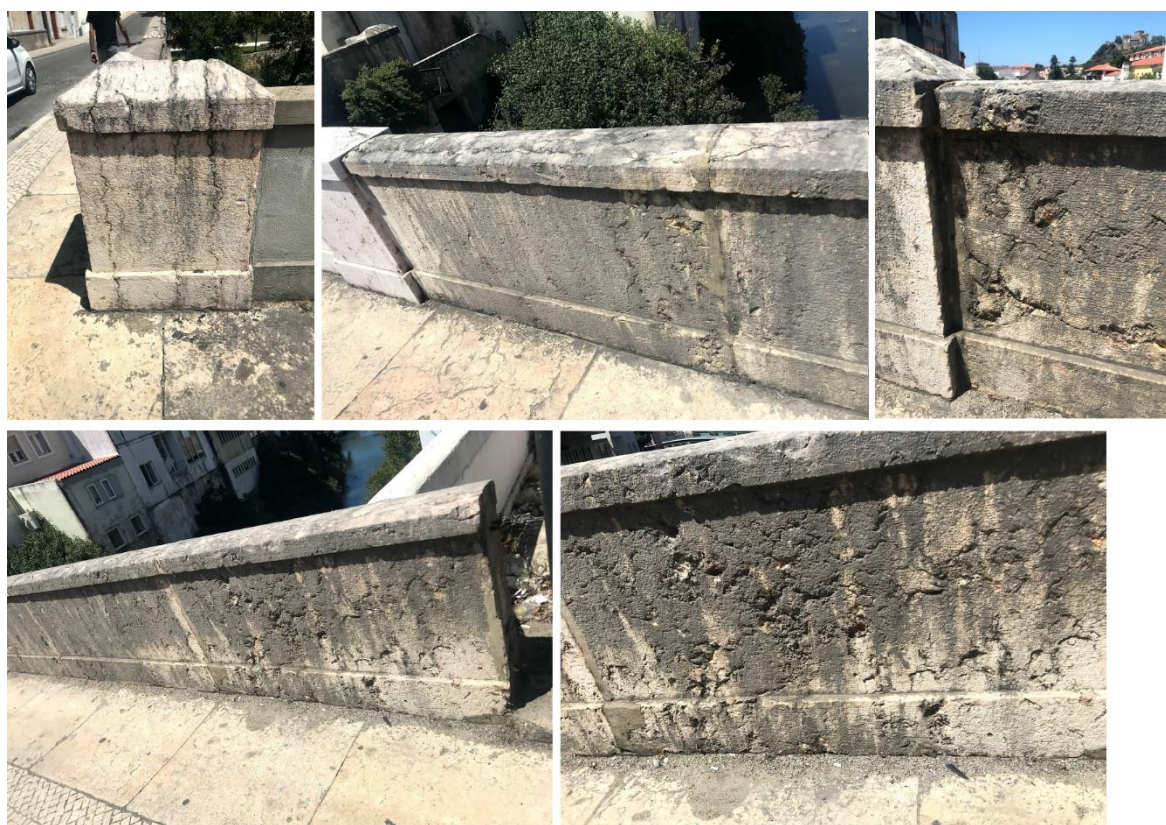
Figura 66 - Deficiência nos guarda corpos.
