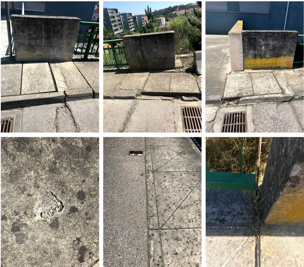
Figura 22 - Patologias nos passeios.
