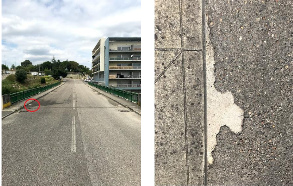
Figura 21 - Delaminação da camada betuminosa.
