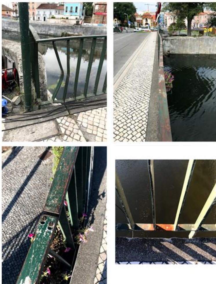
Figura 41 - Deficiência no guarda corpo e sinais de acidentes.
