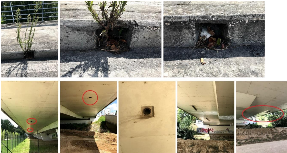
Figura 55 - Deficiência no sistema de drenagem.
