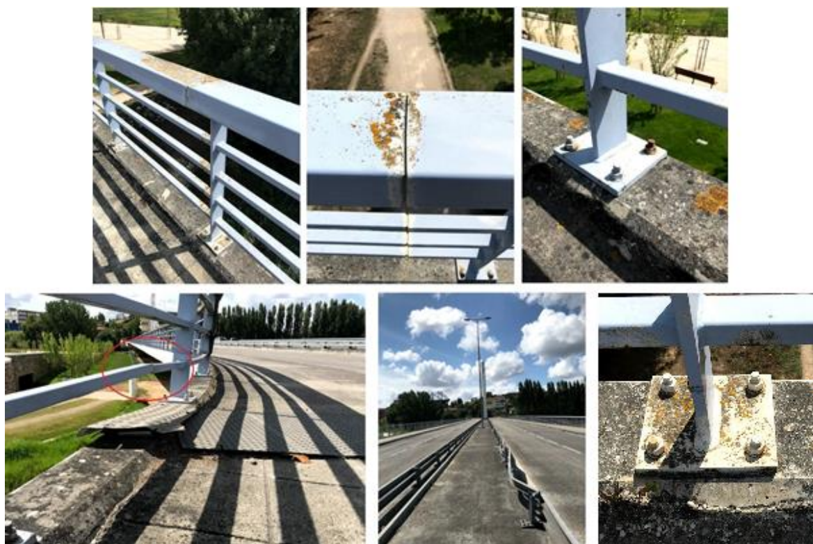
Figura 58 - Patologias nos itens de segurança.
