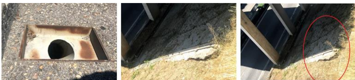
Figura 25 - Deficiência na drenagem.
