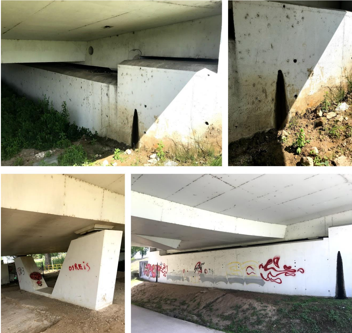
Figura 57 - Manchas, pichações nos encontros e pilar.
