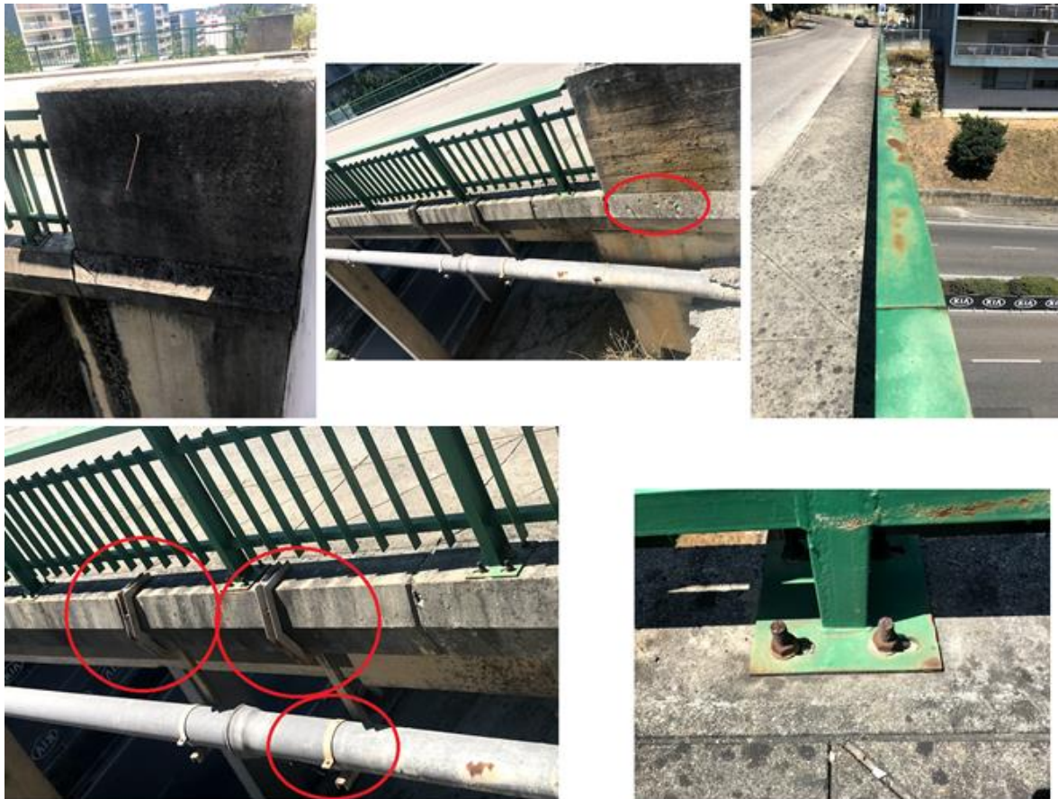
Figura 28 - Patologias nos guardas corpo e muros.
