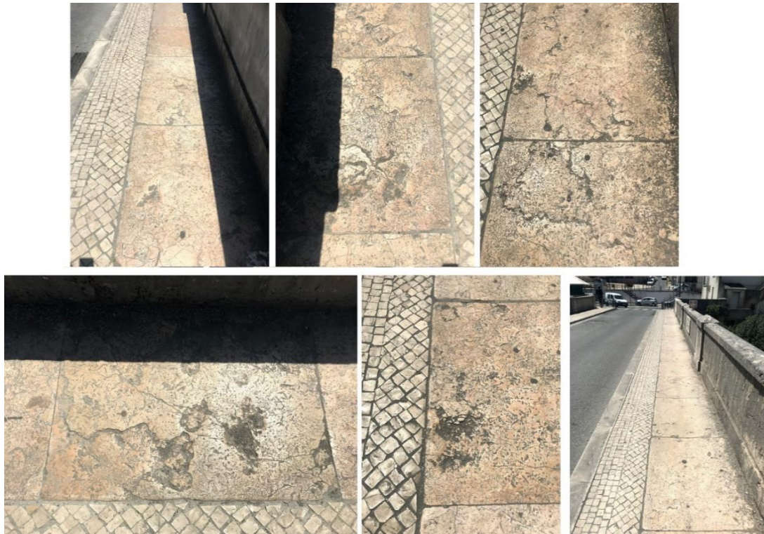
Figura 62 - Patologias nos passeios.
