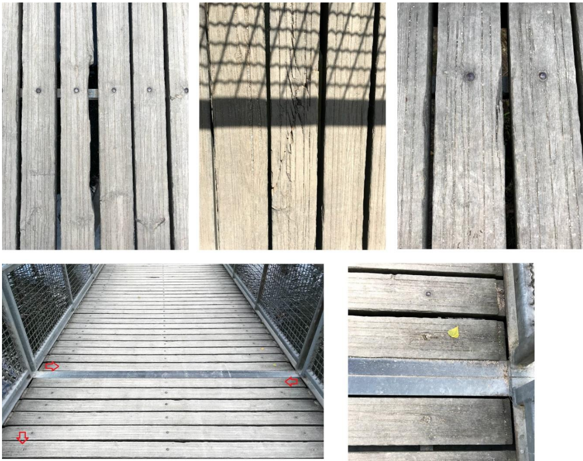
Figura 45 - Patologias encontradas no pavimento, fissuras, delaminação, deficiência nos ligadores.
