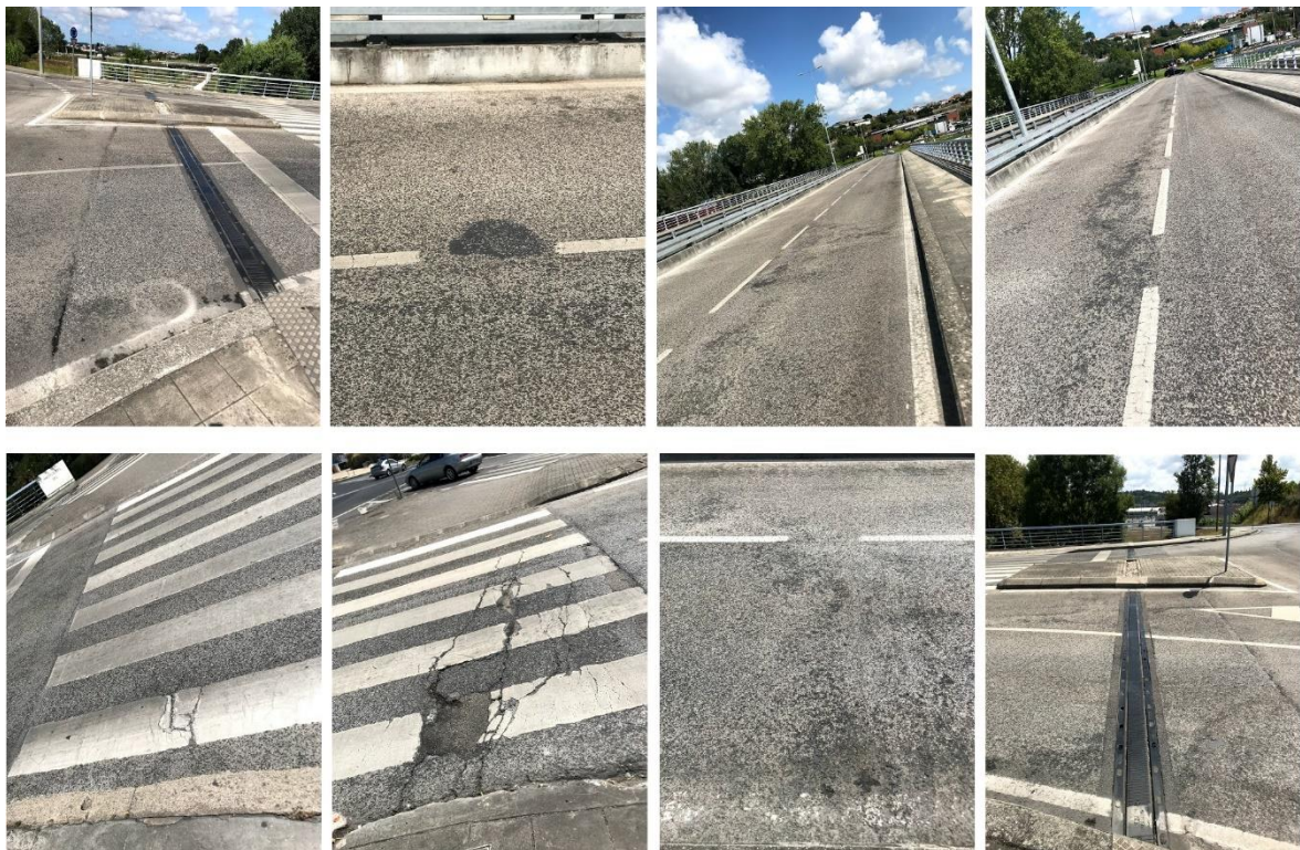
Figura 51 - Patologias encontradas na pista de rodagem.
