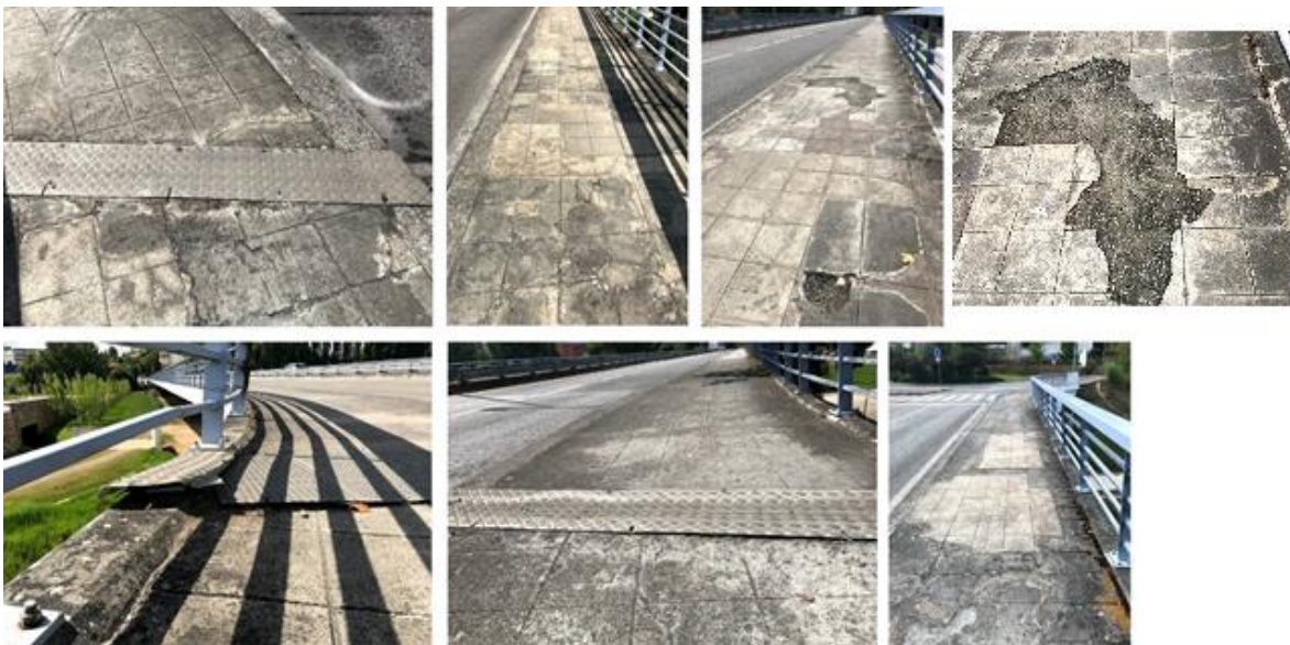
Figura 53 - Deterioração dos passeios.
