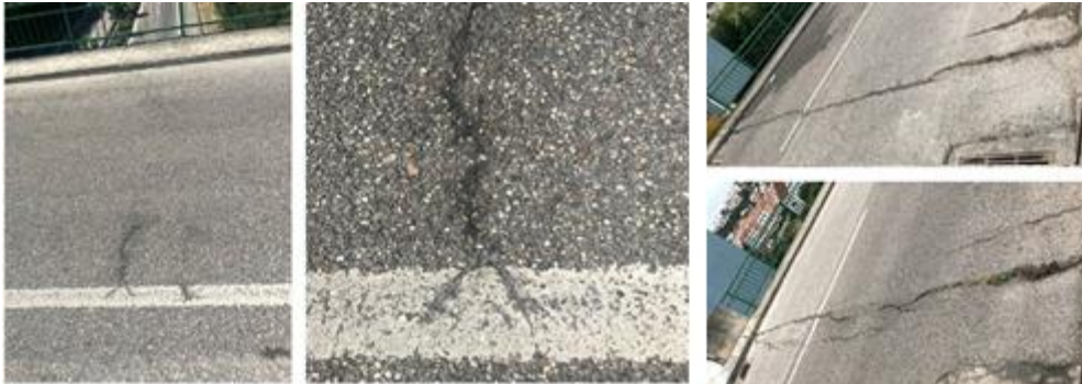
Figura 19 - Fendas transversais e deficiência nas juntas.
