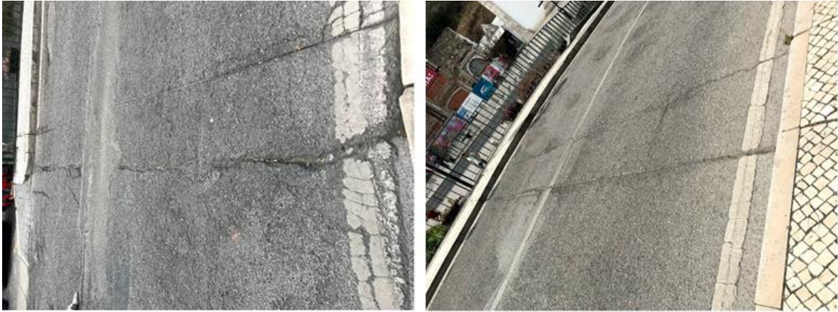
Figura 34 - Deficiência nas juntas de dilatação.
