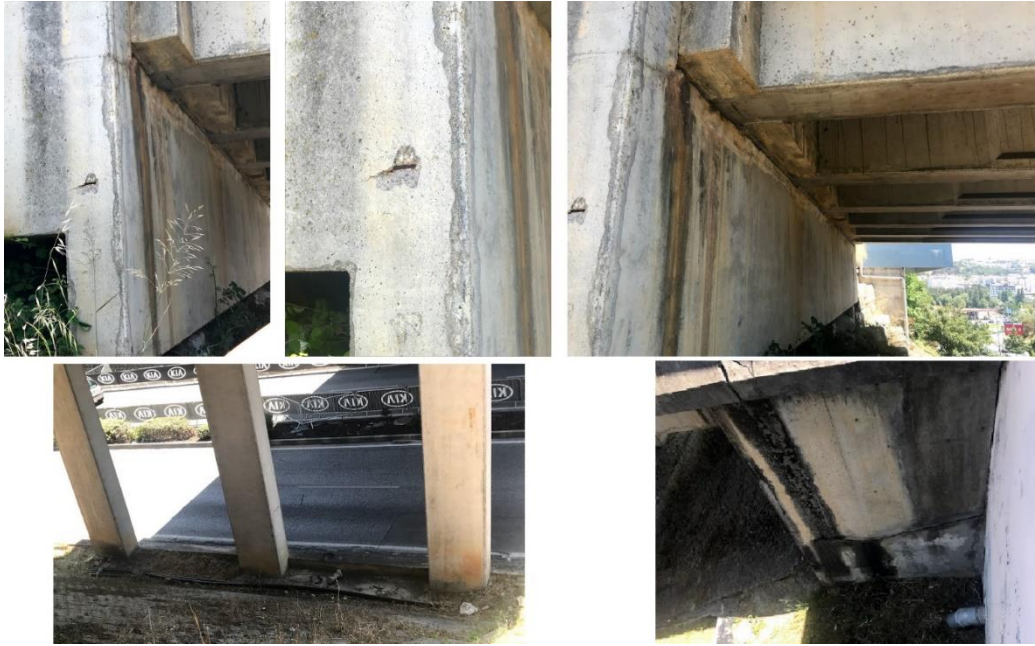
Figura 27 – Patologias na mesoestrutura viaduto.
