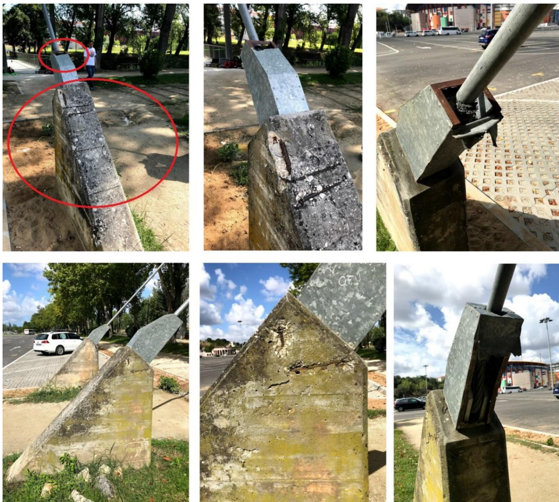
Figura 48 - Patologias nas ancoragens e elementos de proteção dos cabos.
