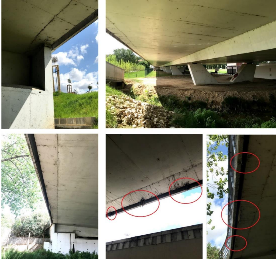
Figura 54 - Fissuras, estalactites e colonização biológica no tabuleiro.
