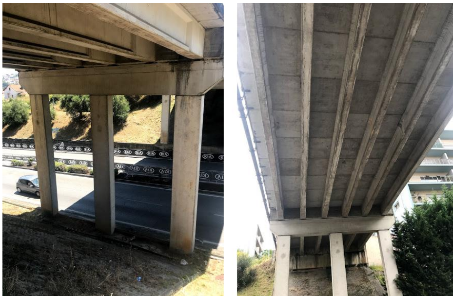
Figura 26 - Vigas com manchas e falhas na superfície.
