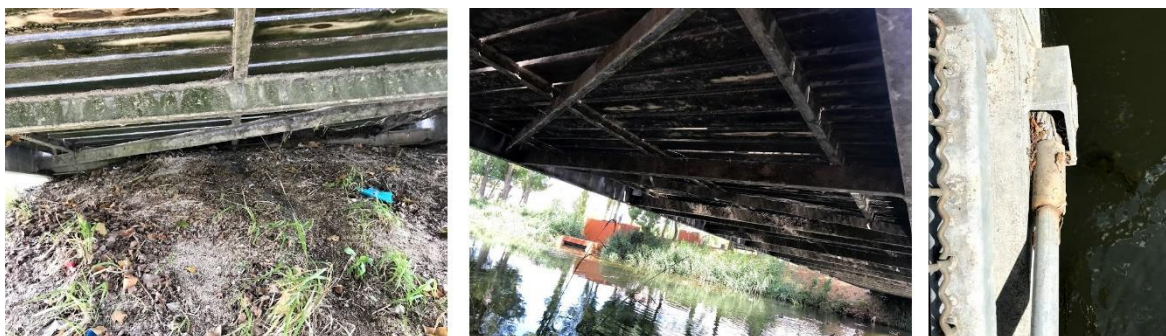
Figura 47 - Deficiência de limpeza.
