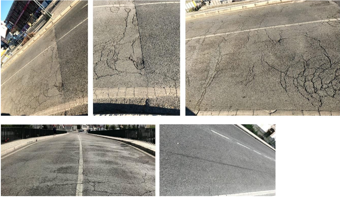
Figura 32 - Fendilhamento na faixa de rodagem.
