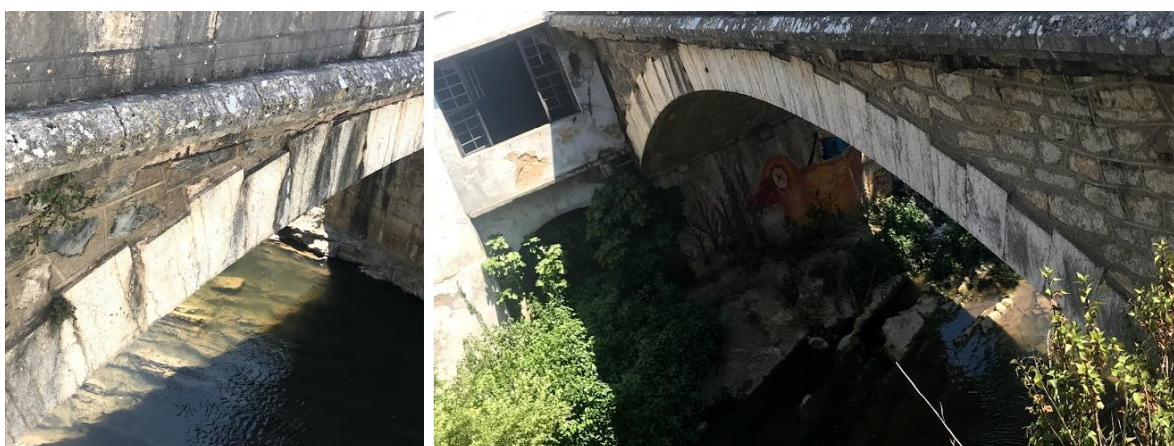
Figura 64 - Fendilhações e manchas na abóbada.
