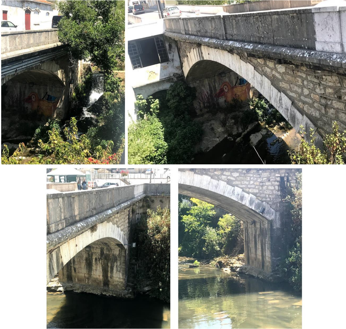
Figura 65 - Patologias observadas na mesoestrutura.
