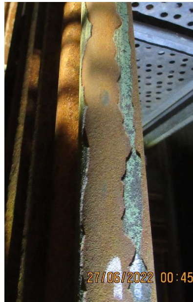
Figura 4.18 – Desprendimento do revestimento
