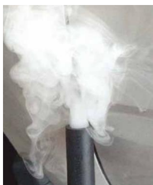
Figura 18 - Detecção de locais de má vedação
