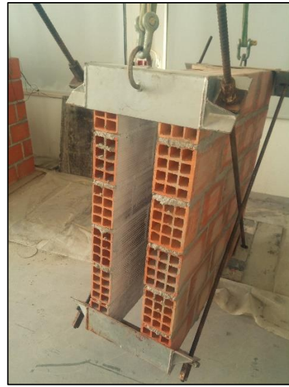
Figura 26 - Movimentação das paredes
