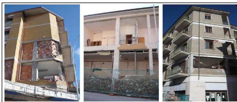
Figura 11 - Colapso de paredes de enchimento para fora do plano (Lourenço, P. et al. , 2011)
