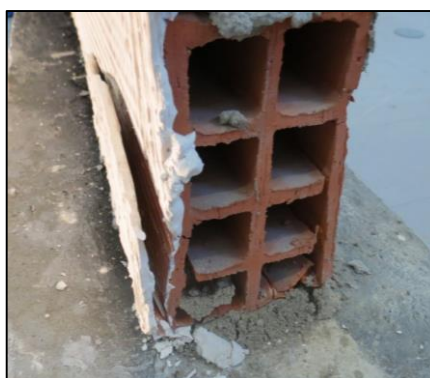
Figura 61 - Rotura dos tijolos na base da parede
