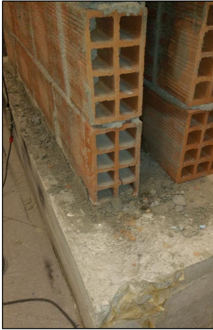
Figura 67 - Fissuração dos septos dos tijolos do pano de tijolos de 30x20x11
