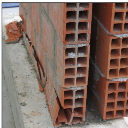
Figura 73 - Rotura da base dos panos de alvenaria
