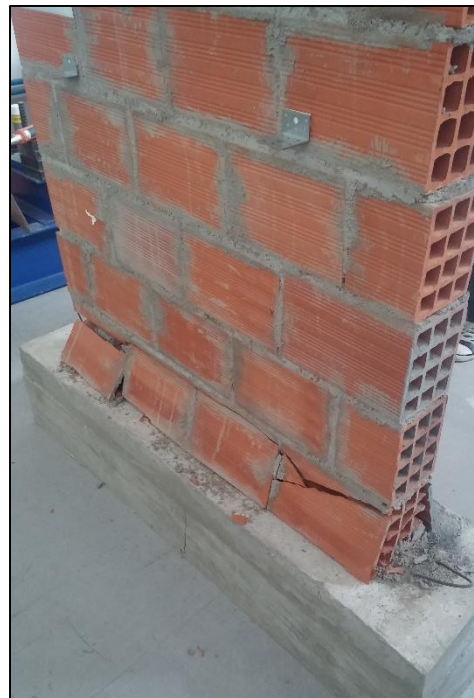
Figura 57 - Rotura total da base da parede
