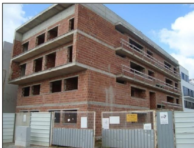
Figura 7 - Inexistência de correção de pontes térmicas ao nível da laje
