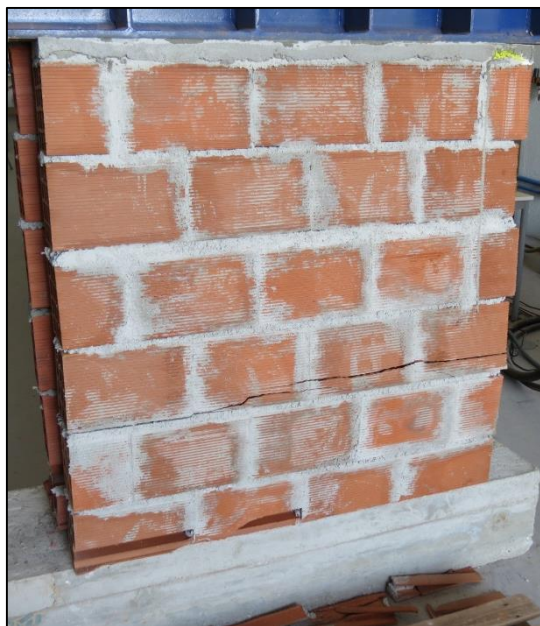
Figura 94 - Fissuração dos tijolos durante o ensaio
