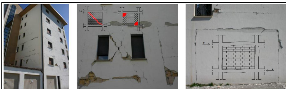
Figura 10 - Fissuração provocada por danos no plano (Vicente, R. et al. , 2010)
