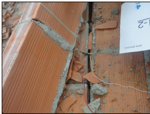
Figura 80 - Estado dos grampos após o colapso
