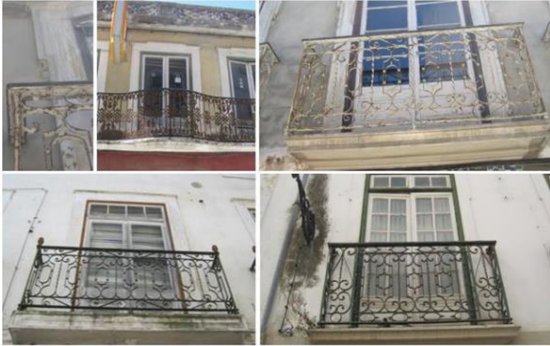
Figura 126 - Anomalias em grades/elementos de ferro de edifícios do CHL
