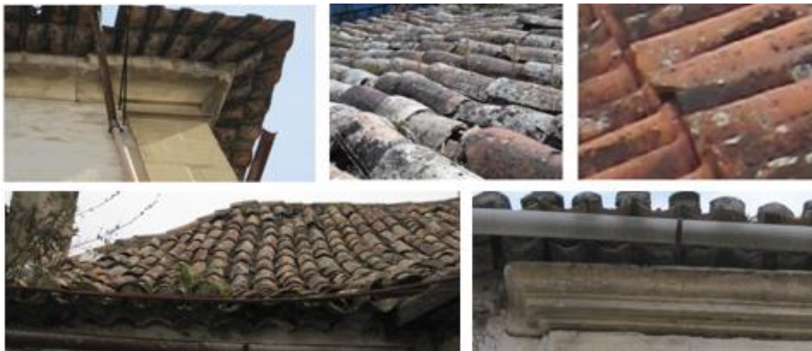
Figura 62 - Exemplos de anomalias das telhas do edificado do CHL
