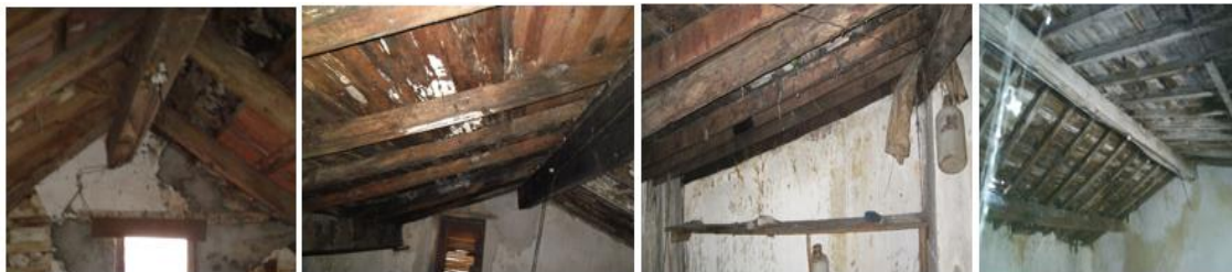
Figura 107 – Coberturas que necessitam de reforço nos edifícios do CHL
