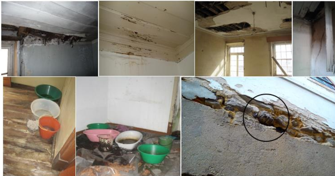
Figura 92 - Vigas dos pavimentos sujeitas a infiltrações e apodrecimento nos edifícios do CHL
