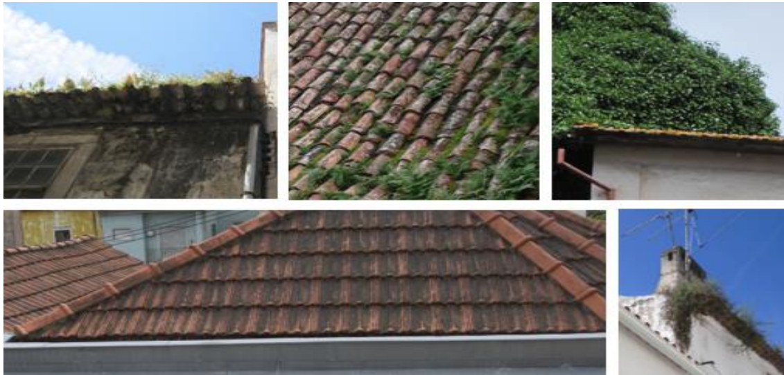
Figura 112 - Aparecimento de musgos e microrganismos nas coberturas do CHL
