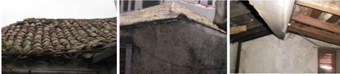
Figura 113 - Deformação das coberturas de edifícios do CHL
