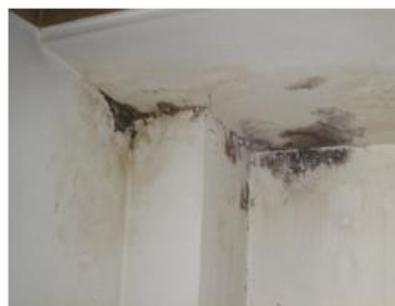
Figura 89 - Condensações no interior de edifícios do CHL
