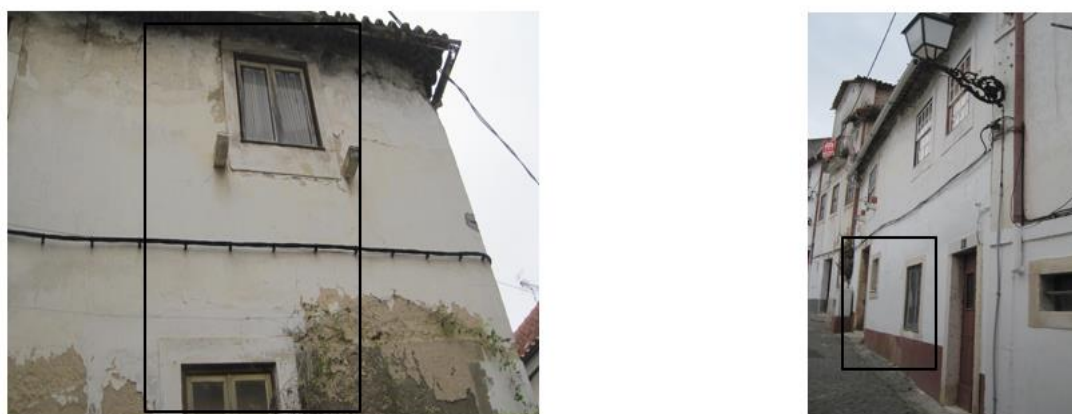
Figura 38 - Exemplos de edifícios com desalinhamento entre vãos no CHL
