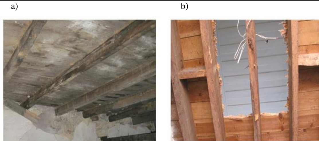
Figura 72 - Edificado do CHL: a) Fragilização junto à parede; b) Fragilização entre vigamento
