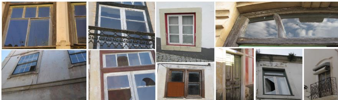
Figura 123 - Anomalias em caixilharias de edifícios do CHL
