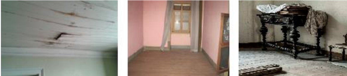
Figura 101 - Deformação dos pavimento em edifícios do CHL
