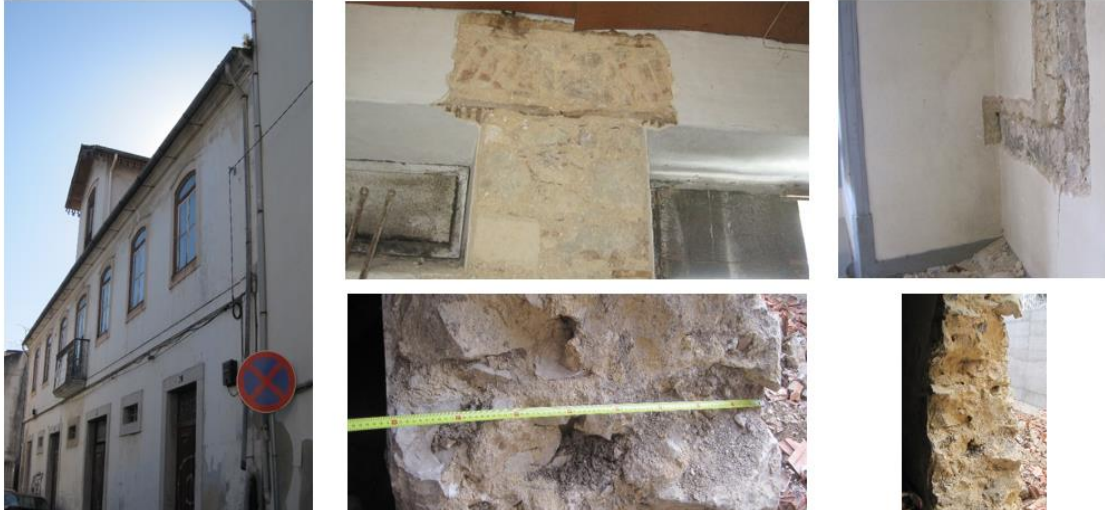
Figura 75 - Paredes de fachadas de um edifício do CHL (A49; Figura 11)
