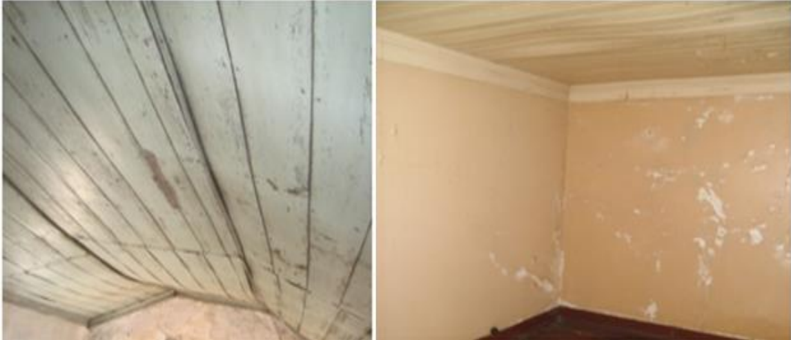
Figura 119 - Fendas e empenos em forros dos revestimentos dos tetos de edifícios do CHL
