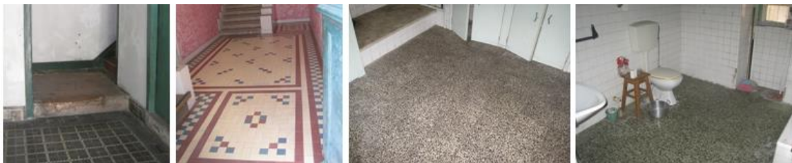
Figura 54 - Exemplo de anomalias em revestimentos cerâmicos do edificado do CHL
