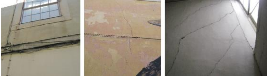
Figura 87 - Fissuração por assentamentos diferenciais em edifícios do CHL
