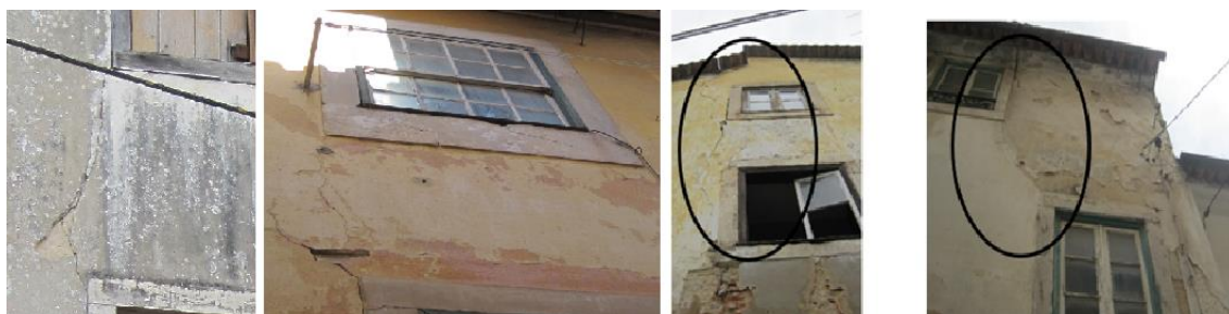
Figura 86 - Fissuração devido à concentração de tensões em edifícios do CHL
