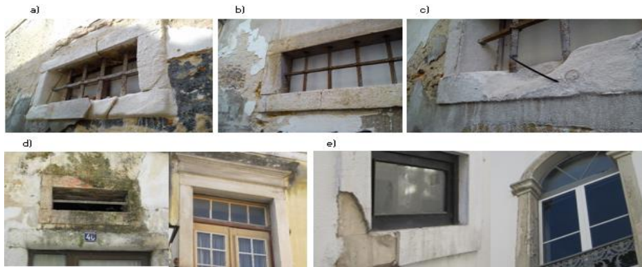
Figura 122 - Edifícios do CHL: a) Desgaste da pedra; b) Fendilhação da pedra; c) Fracturação da pedra; d) Sujidade da pedra; e) Sobreposição com argamassa e/ou tintas das cantarias
