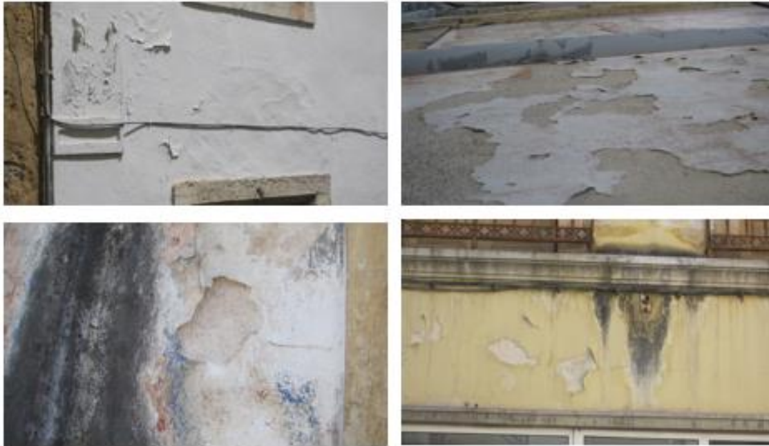
Figura 79 - Tinta descascada e empolada de edifícios do CHL
