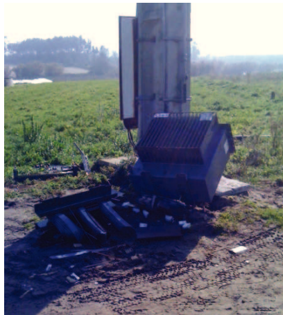
Figura 12 - Derrame de óleo em transformador furtado
