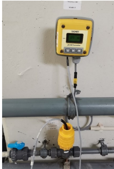
Figura 11- Sonda ligada ao sistema de suporte de vida, medindo os valores de ORP
