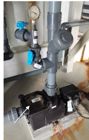
Figura 7 - Bomba de circulação de água, seta a indicar pré-filtro
