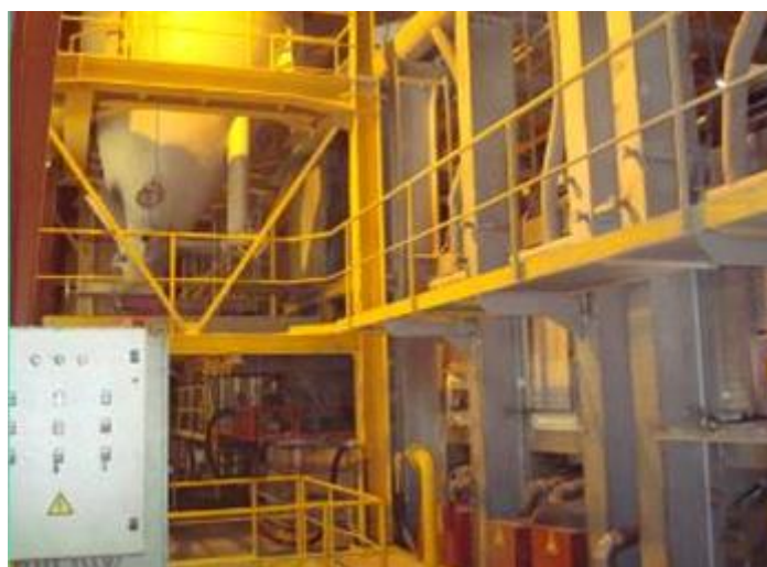
Figura 3: Silos de enforna e enfornadores.
