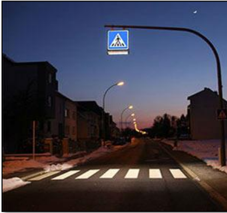
a) Luminária verticais do tipo H7 suspensas iluminado com os sistemas LEDs
