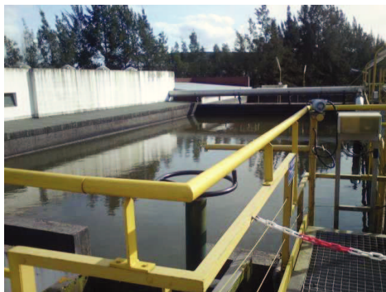
Figura 27 – Tanque de lamas activadas
