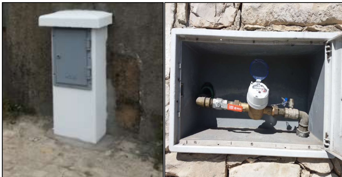
Figura 13: Infraestruturas da rede: ramal de ligação a boca-de-incêndio (esquerda) e contador doméstico (direita)
