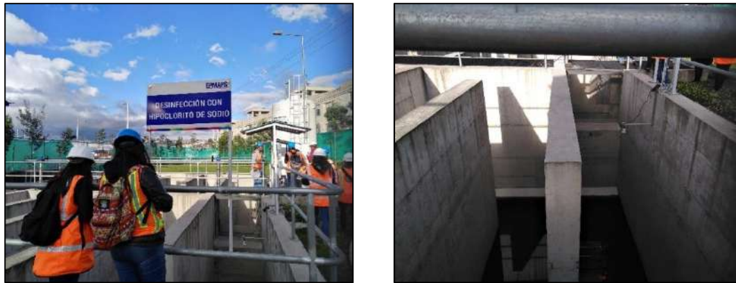
Figura 26. Unidad de desinfección con hipoclorito de sodio, PTAR Quitumbe, Quito-Ecuador.
