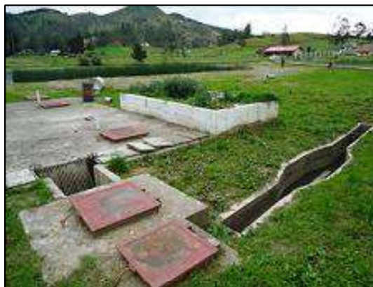
Figura 17. Desarenador, PTAR Tarqui Centro, Victoria del Portete-Ecuador. Fuente: https://bit.ly/2oEKA8 (accedido el 04 de abril de 2018).
