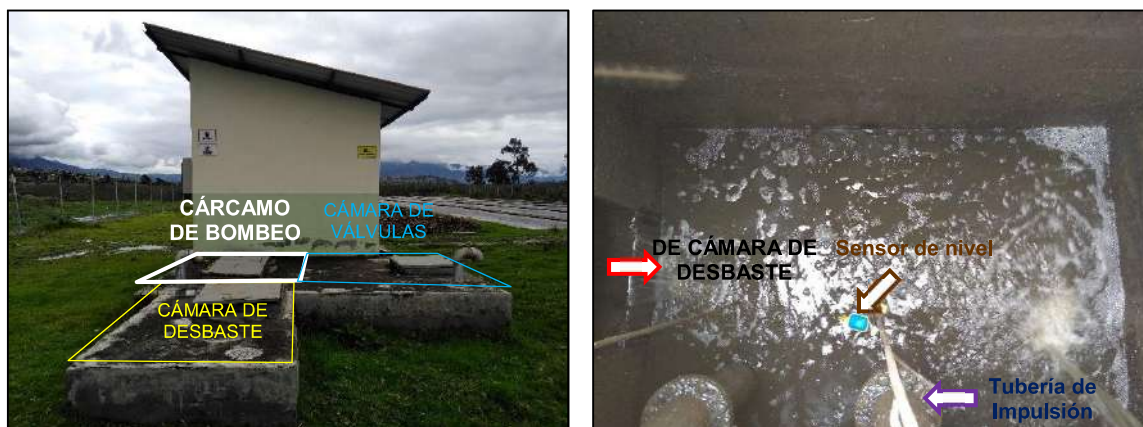
Figura 43. Cárcamo de bombeo.
