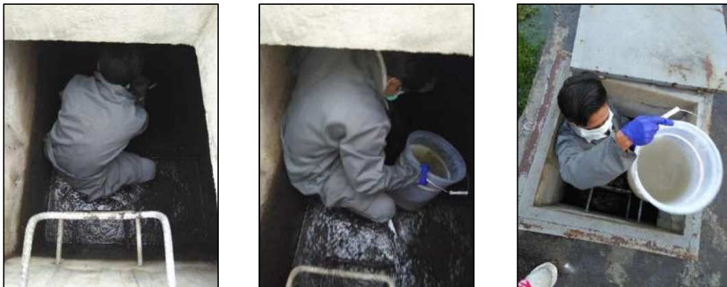
Figura 74. Aforo de caudal en la entrada de la PTAR (cámara de desbaste).
