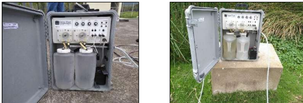
Figura 77. Recolección de muestra de agua residual mediante muestreador automático a la salida del sedimentador = Entrada FAFA y salida de la PTAR (Estructura de descarga).
