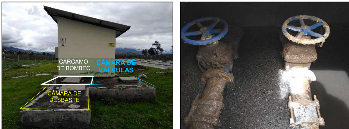
Figura 44. Válvulas de compuerta – Estación de bombeo.
