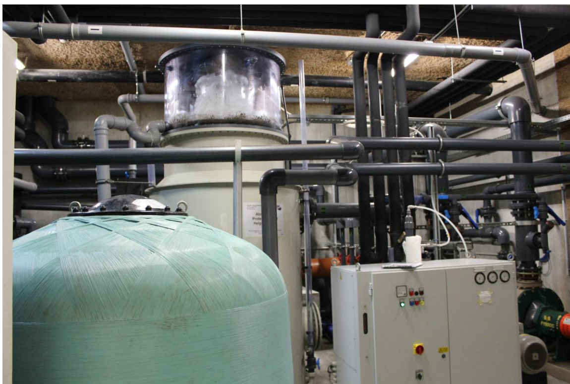
Figura 2.9 – Panorâmica da sala do sistema de suporte de vida (Foto de: Miguel Paiva)
