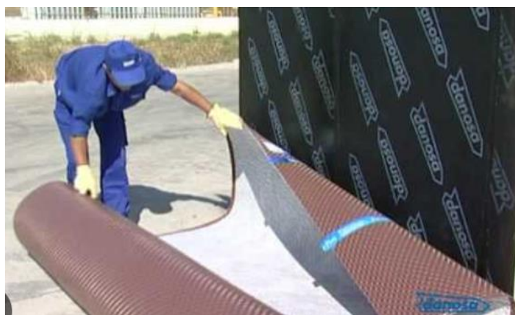
Figura 60- Impermeabilização de parede enterrada com tela asfáltica e tela pitonada. Danosa Portugal.
