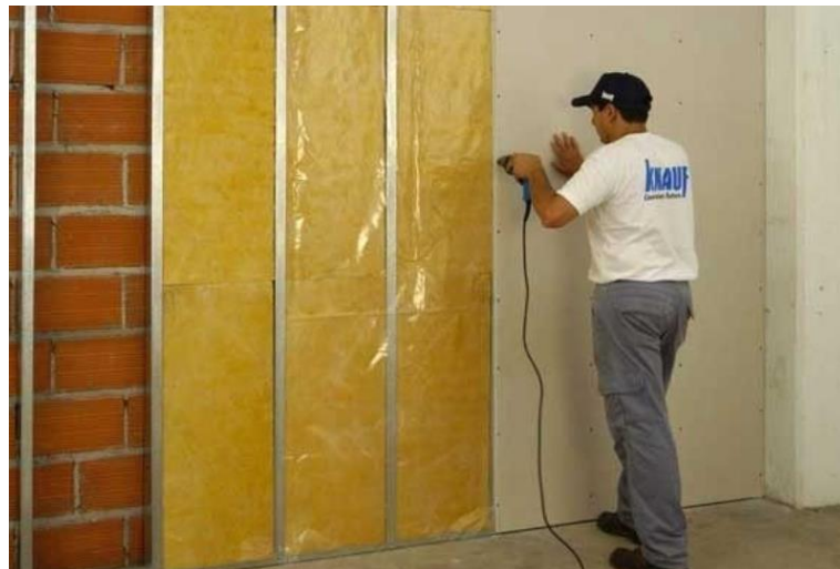
Figura 75- Aplicação de placas de gesso cartonado no interior de parede de alvenaria, utilizando perfis metálicos. https://www.pinterest.pt/pin/335588609726506022/ . 2023
