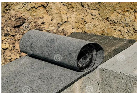
Figura 57- Impermeabilização da base de parede de blocos com tela de xisto. https://pt.dreamstime.com/impermeabiliza%C3%A7%C3%A3o-da-base-de-uma-casa-em-constru%C3%A7%C3%A3o-material-imperme%C3%A1vel-laminado-betume-duas-camadas-encontra-se-na-parede-image212833509 . 2023
