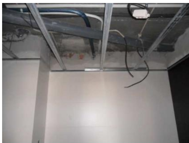
Figura 73- Tubagem embutida em teto falso. Borges, T. ISEL. 2012
