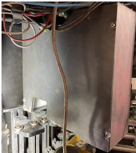
Figura 51 - Estado atual das tampas do Génio
