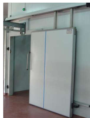
Figura 5.12. Câmara de matéria-prima/produto acabado (Frigoríficos Brígido, 2013).
